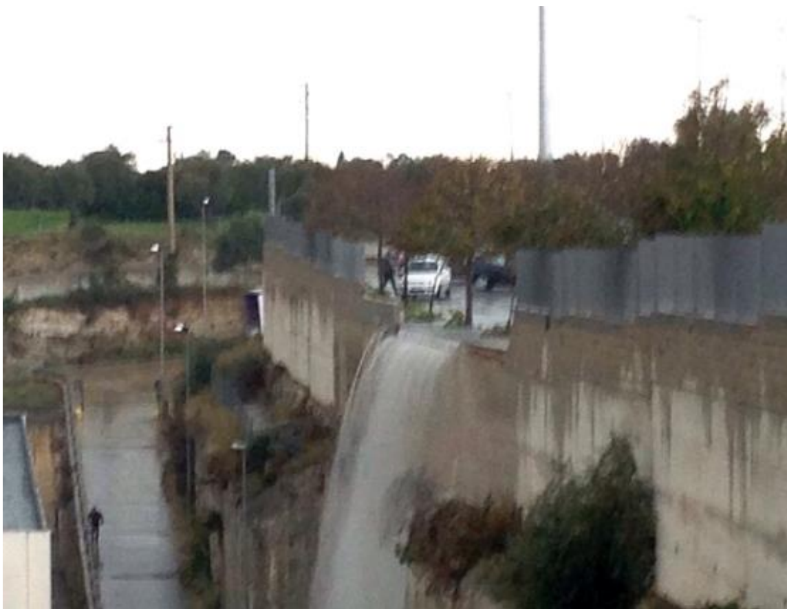
Figura 14: Conseguenze dell'evento del 26 novembre 2015: crollo del muro alle spalle del negozio Conforama ( https://bit.ly/2FfxwAh )
