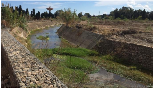
Capoterra (CA), digues du ruisseau S. Girolamo
