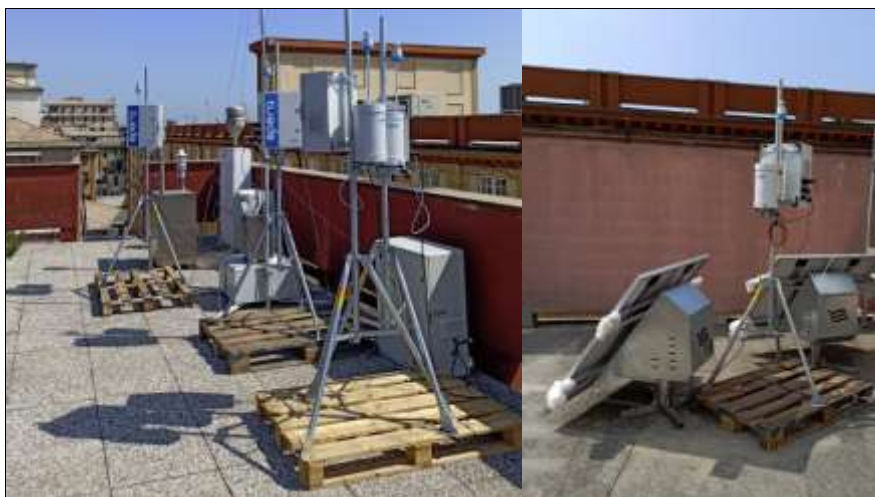
Figure 5.4.1.5. Systèmes smart et instrumentation conventionnelle sur la terrasse du siège d'ARPAL.
