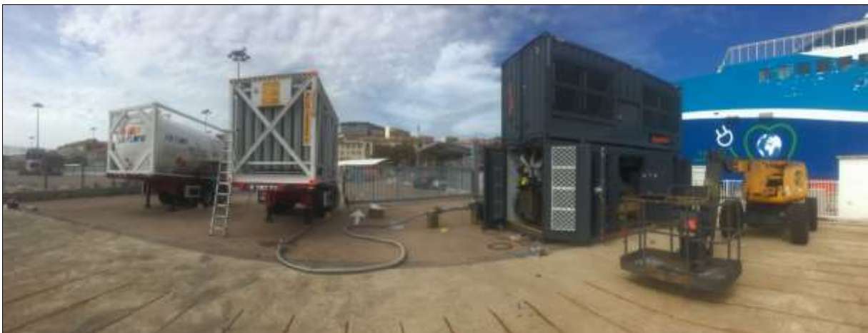
Figure 5.5.2. Station GNL pour raccordement électrique.
