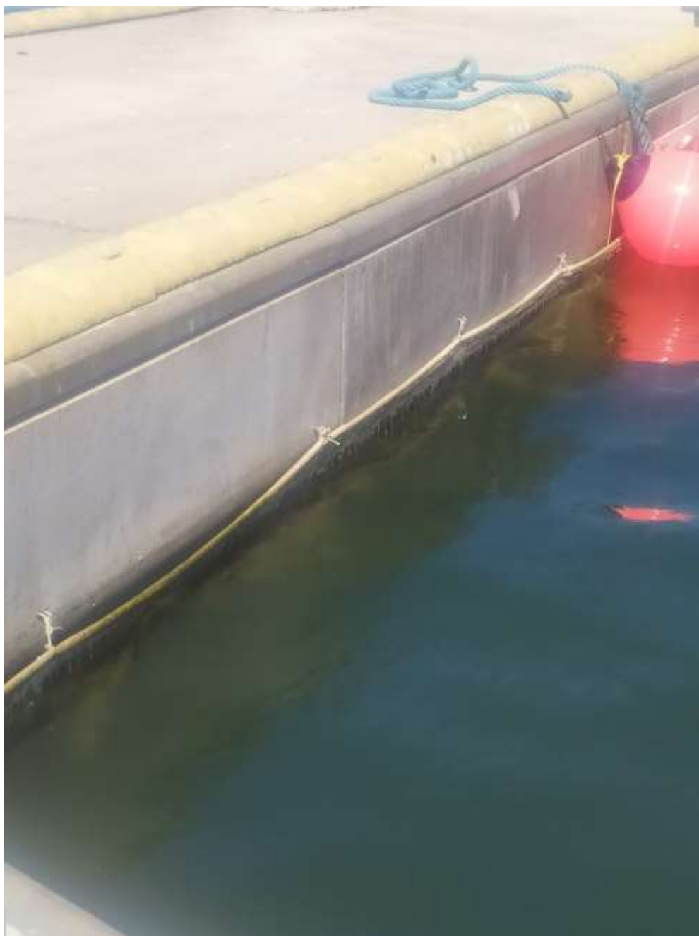
Figura 6. Banner deteriorato e alto livello della marea
