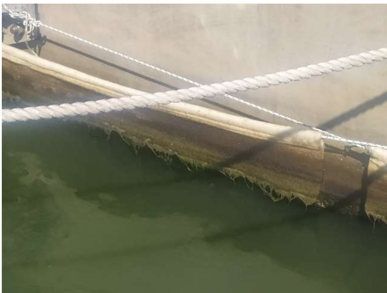
Figura 5. Dettaglio deterioramento banner con colonizzazione alghe
