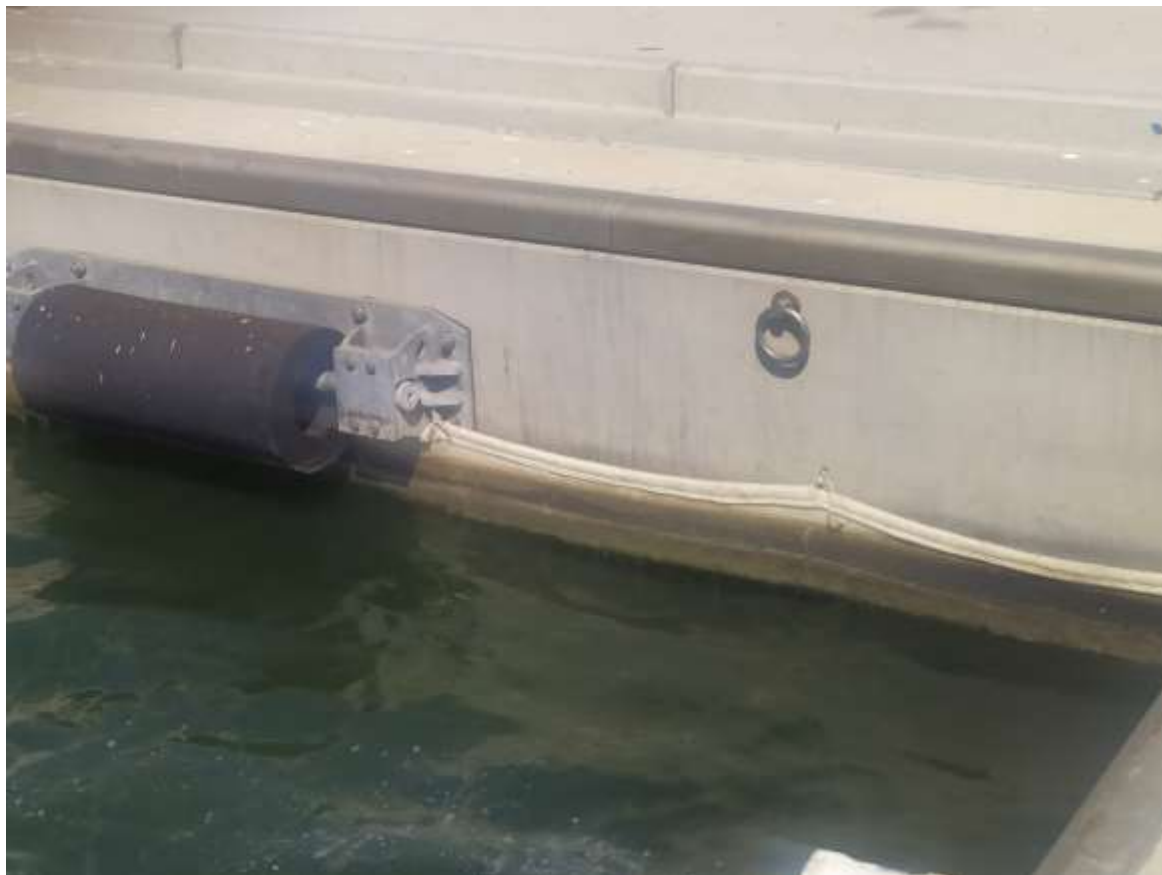
Figura 7. Dettaglio banner deteriorato e visibile linea di rottura netta
