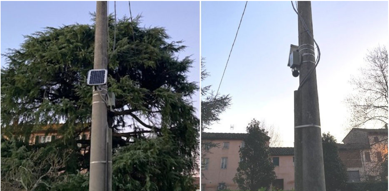
Figure 5 - Capteur acoustique à faible coût installé dans la Via di Carraia près de l'école
