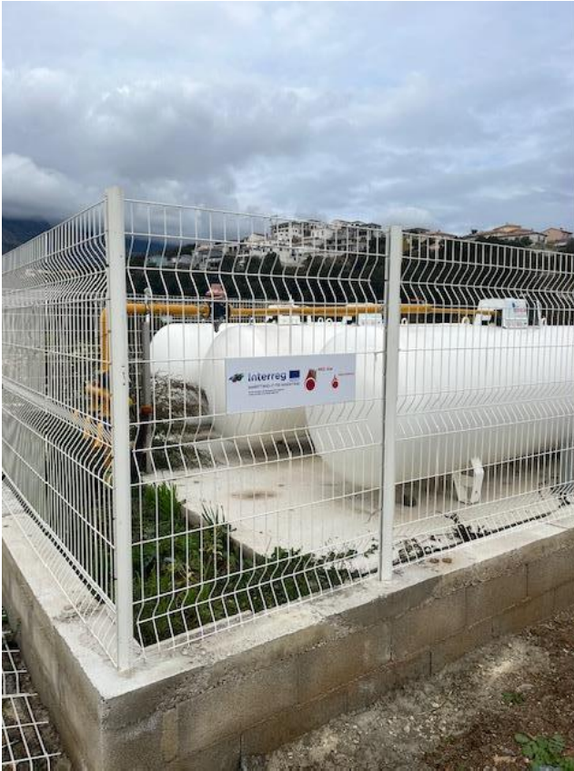
Foto13. Serbatoi di gas
