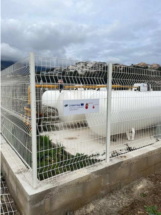
Fig.13. Cuves de gaz
