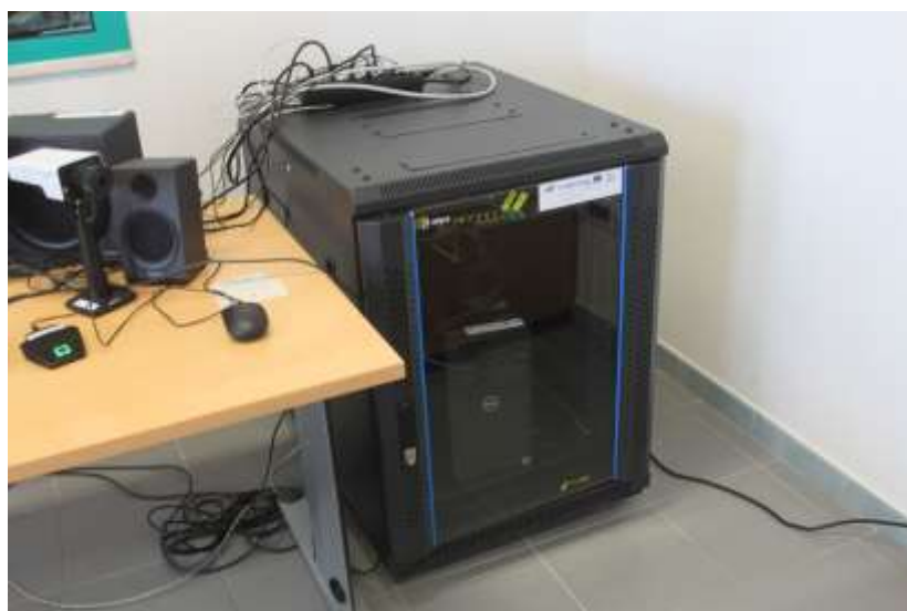
Figure 3 : Détail du rack 19 pouces et du PC.
