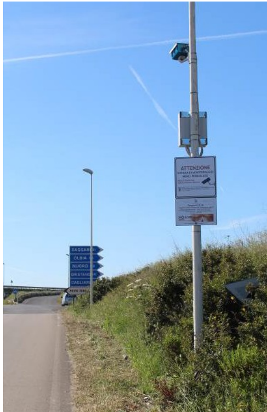
Figura 4: una delle postazioni installate a Porto Torres
