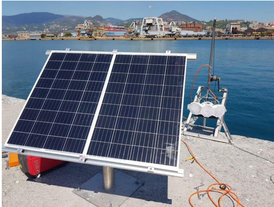
Pannello solare di alimentazione della stazione.
