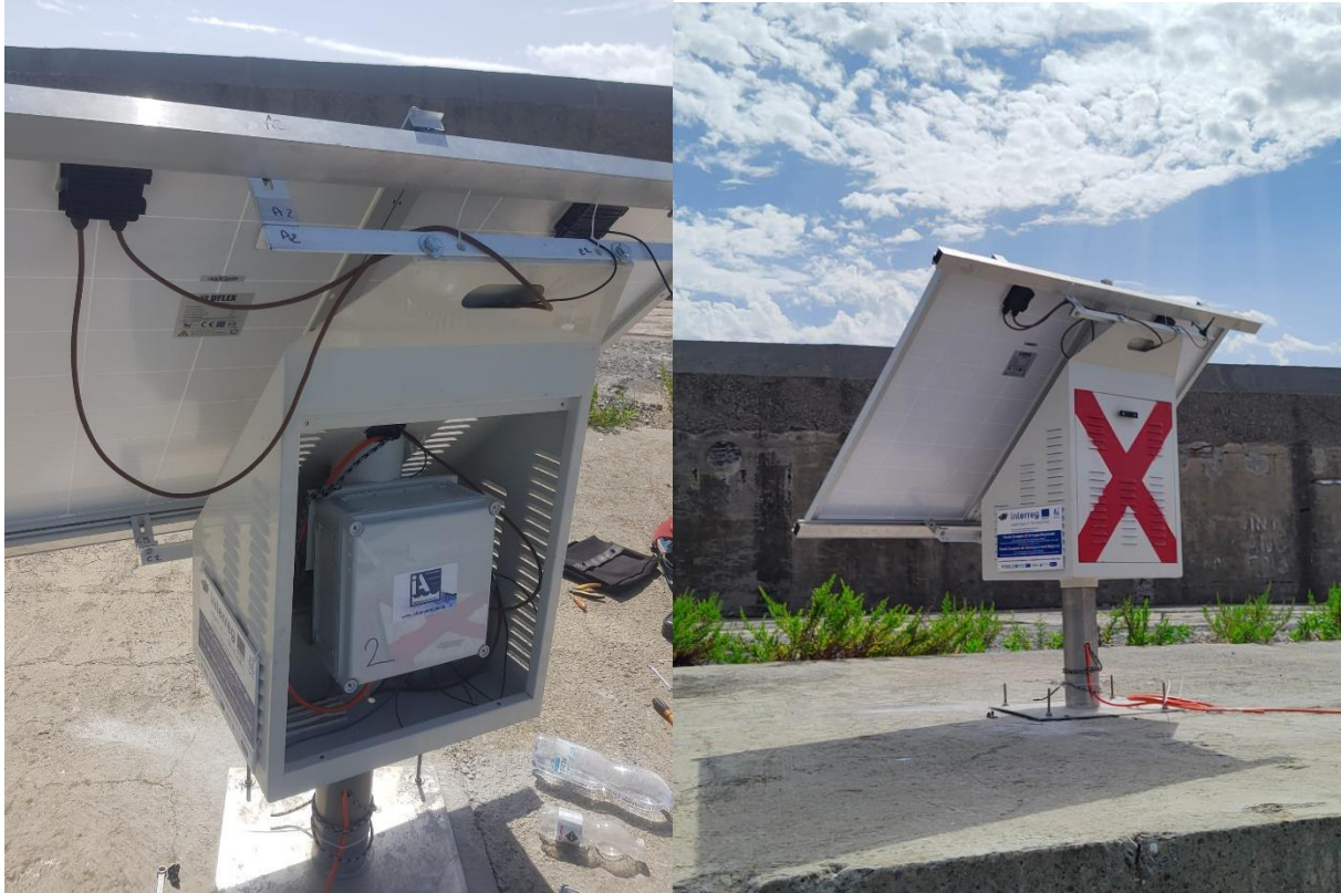
Centralina elettronica e cabina contrassegnata con una X rossa.
