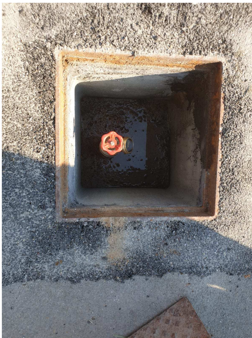
Figura 9: Nuovo idrante realizzato
