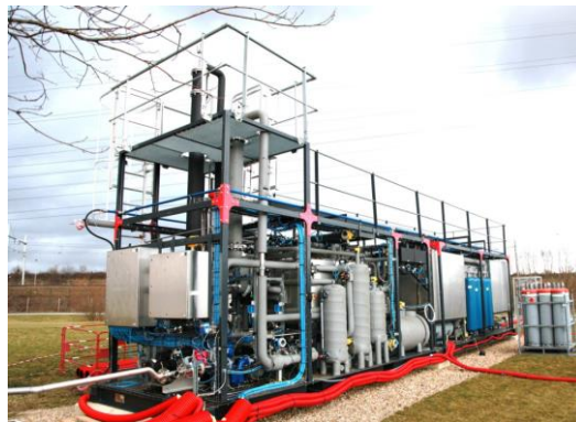
Figura 15 : Foto dell'impianto BioGNVAL (fonte: ADEME)
