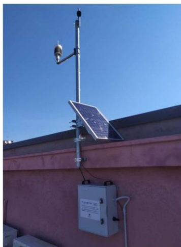
FIGURE 3 : EXEMPLE DE STATION DE SURVEILLANCE INSTALLÉE DANS LE PORT DE CAGLIARI.
