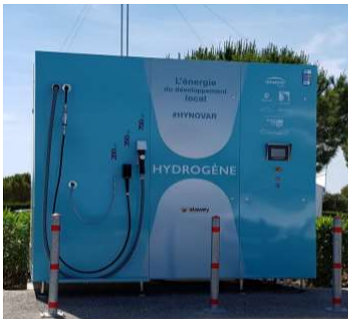
Foto 6 : Stazione di produzione e di distribuzione di H 2 , installata sull'altipiano di Signes
