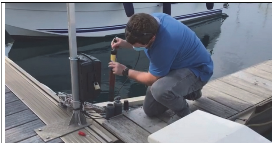
Sistema di sorveglianza presso il Porto Charles-Orano
