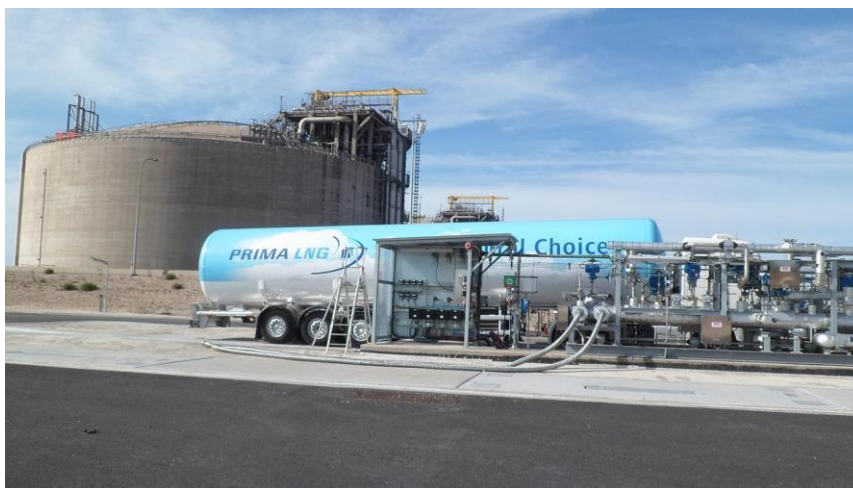
Figure 3 : Photo du chargement d'un camion-citerne GNL sur le terminal méthanier de Fos Cavaou
