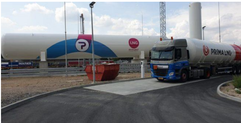
Figure 20 : Photo du déchargement de GNL depuis un camion-citerne vers la station de soutage dans le port de Cologne
