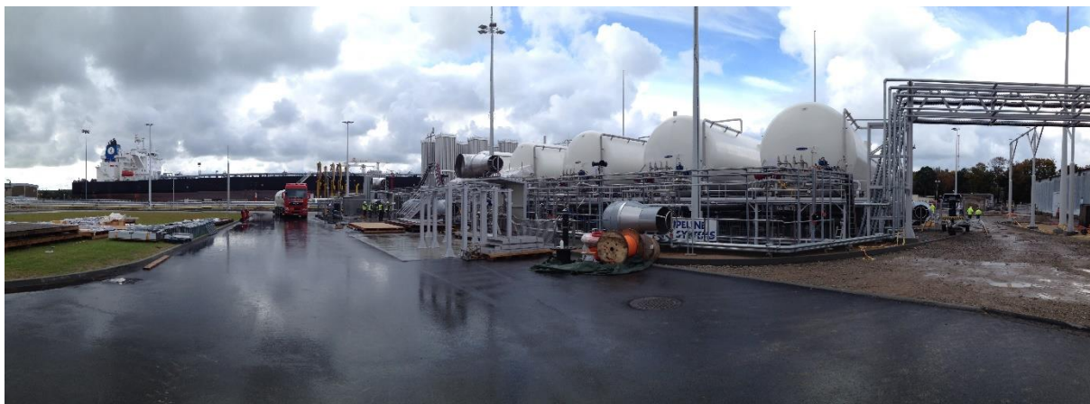
Figure 18 : Photo de la station de soutage de navire de Klaipeda
