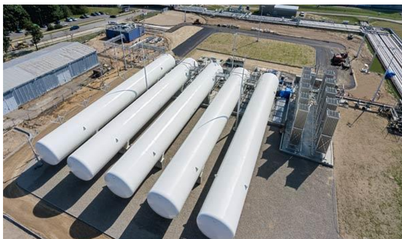
Figure 34 : Photo de réservoirs pressurisés (CHART)
